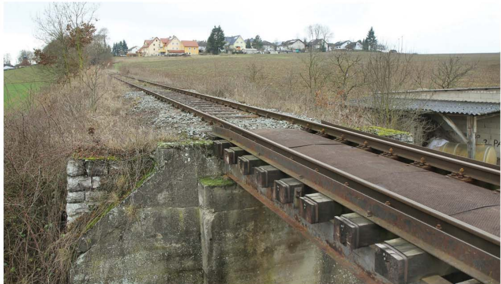
Die Brückenbauwerke sind ein neuralgischer Punkt der Bahnlinie Strullendorf - Schlüsselfeld. Mit den Ausbesserungsarbeiten des vergangenen Jahres ist man bei der Regierung von Mittelfranken noch nicht zufrieden. Foto: Michael Gründel
